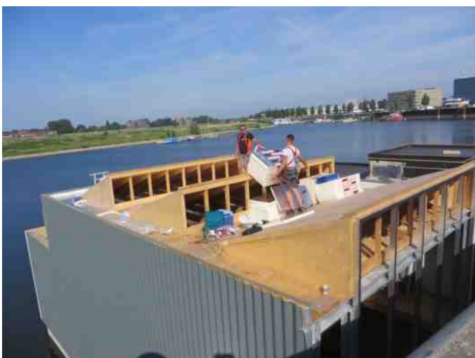
Met stukjes en beetjes vorderde deze zomer de afbouw van de loods. Twee jongens van een onderaannemer bevestigen de langverwachte kunststoframen in dakconstructie. Inmiddels ligt de loods op zijn plek en wordt er gewerkt aan electriciteitsbedrading en opbouwen van de stellingen waarop de boten komen te liggen.
