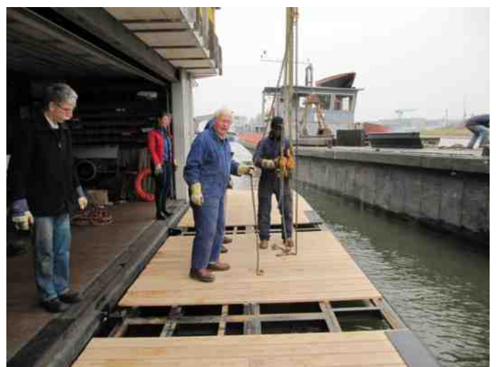
Onderhoud en vernieuwing van onderdelen in het groot en in het klein hoort bij de zorg voor alle materie, dus ook bij verenigingen kost dat tijd en pecunia. Het nieuwe vlot was in 2011 het slotstuk van de vernieuwing van de vloer in de loods. Paul Koch, Helena Dijkstraen Flip Deinum helpen mee. Scheepswerf Misty had zich ontfermd over de staalconstructie daarvan. Het met hout aftimmeren deden de roeileden zelf.
